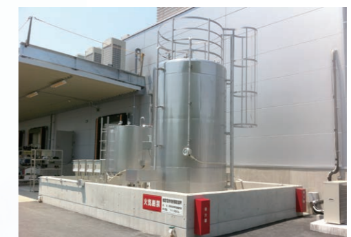
新油タンク + 廃油タンク
