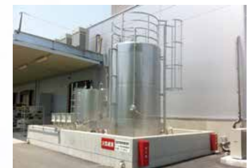
新油タンク + 廃油タンク
