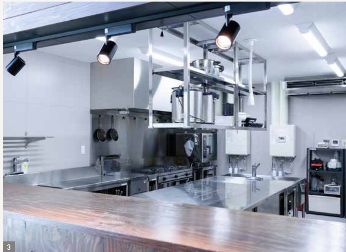
1 この日、調理室1では「日月カフェ」が営業。自家栽培のハーブを使った「本日の野菜プレート」は、色鮮やかな地元産の野菜を使用。 2 調理室1には、ガスレンジなどが入っている。カフェや仕込みにぴったりなコンパクト設計。 3 調理室2には、スチームコンベクションオープンやフライヤーが設置され、大量調理が可能。
